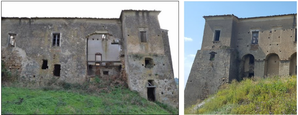
Fig. 10- Il degrado delle facciate
