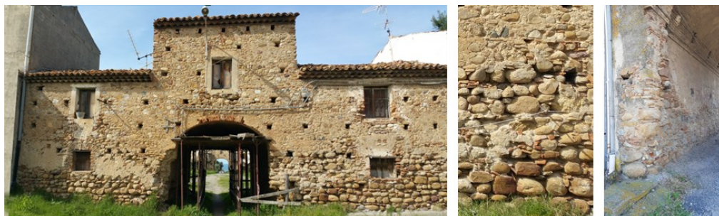
Fig. 9- Facciata con arcata e suo degrado
