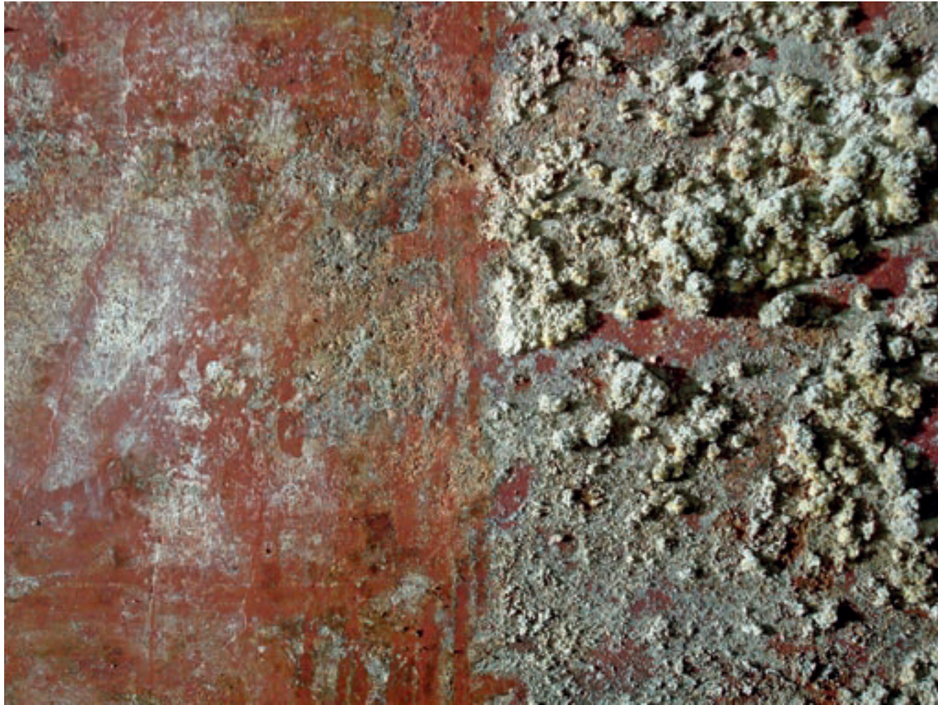
Fig. 6 Domus Aurea, Ambiente 63: fenomeni di abrasione e cadute della pellicola pittorica interessata da efflorescenze saline (Parco archeologico del Colosseo, Archivio)
