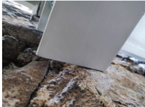
Fig. 12- Particolare della mensola di sostegno della scala; si noti l'esigua distanza rispetto alla muratura della torre (foto di Matteo Pierotti, 2022)
