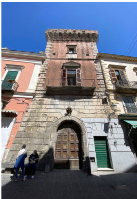
Fig. 5- Torre Quattrocchi, sul Corso F. Regine. Il mediocre stato di conservazione delle superfici esterne della torre, incrementato da aperture che ne alterano l'architettura (Annamaria Ragosta, 2022)
