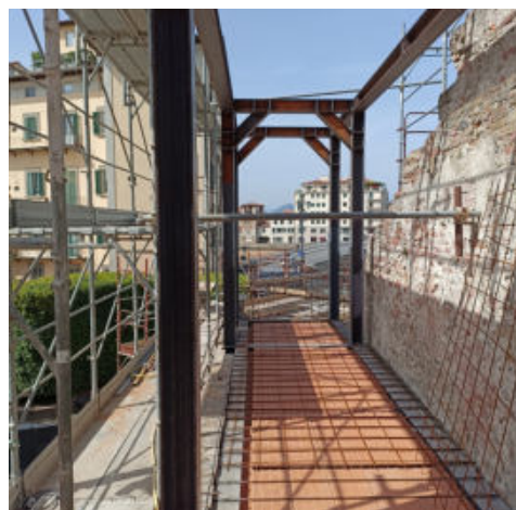
Fig. 9- Vista dei portali in acciaio che costituiscono lo scheletro della porzione di muratura ricostruita (foto di Matteo Pierotti, 2022)
