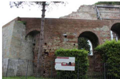
Fig. 5 - Porzione di mura crollate nei pressi della torre S. Antonio, prima dell'intervento di ricostruzione (foto di Matteo Pierotti, 2019)
